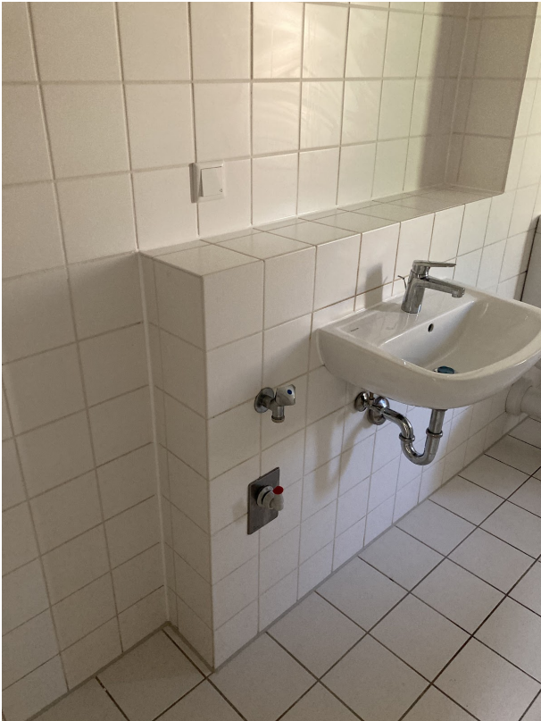
Bad mit Waschmaschinenanschluss
